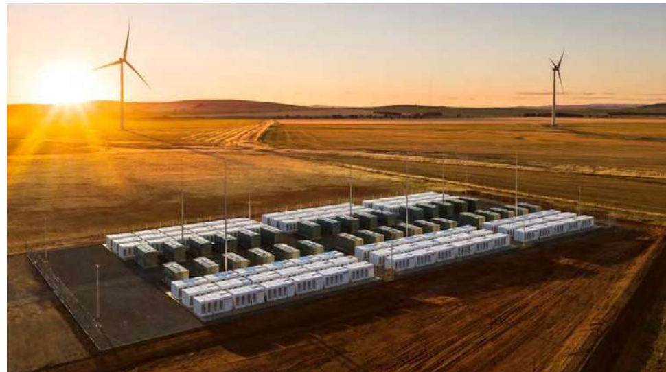
البطارية في محطة Hornsdale Power Reserve بجنوب أستراليا.
