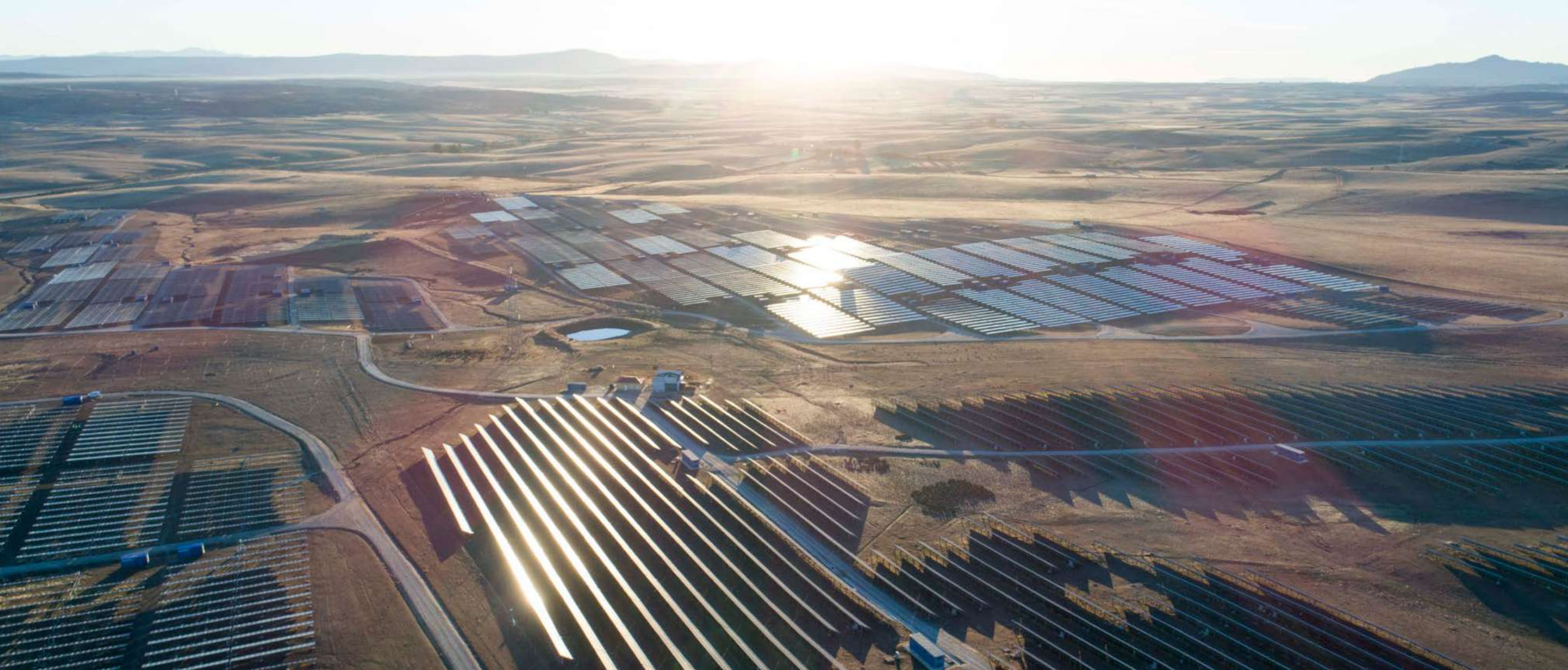
أنشئت شركة فوتوواتيو رينيوابل فينتشرز (FRV) على مساحة 46,20 هكتار محطة للطاقة الشمسية في تروخيلو (إكستريمادورا) بإسبانيا، (تمتلكها/تديرها الآن شركة Vela Energy)، بقدرة 11,55 ميغا واط ويبلغ إنتاجها السنوي 21959 ميغا واط حيث تزود 6297 منزلاً بالكهرباء مع تجنب 7153 طن من ثاني أكسيد الكربون سنوياً.
